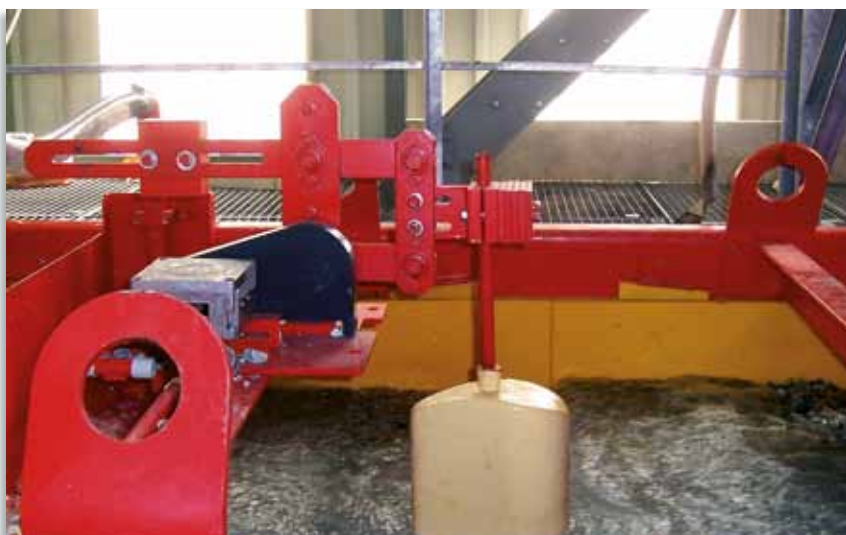
Wnętrze koryta górnego - widok pływakowego czujnika poziomu
